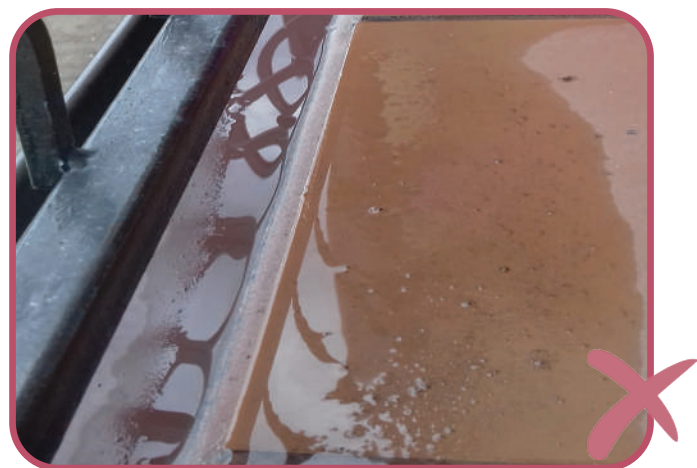
NIEWŁAŚCIWE ODPROWADZENIE WODY Z POSADZKI
